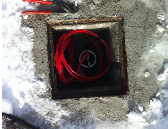
Fig. 27 - Pozzetto C6 bis. Terminale in acciaio a cui sono ancorate le sonde inclinometriche fisse.
